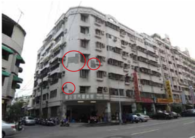
磁磚脫落影響人行安全外，凌亂的招牌與鐵窗亦影響大樓整體景觀
